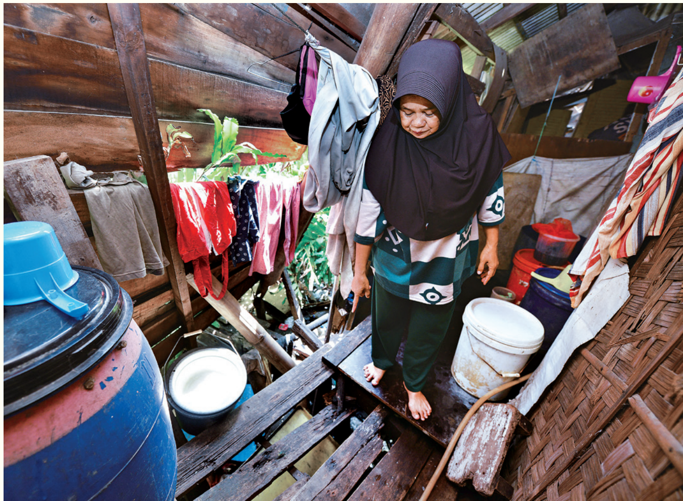
ボランティアは2024年11月、ジャカルタのカマラ・ムアラ村で第6期の住宅修繕をする前の訪問を行った。家主のココム・コマリヤさんは、木の床が腐って割れていたため、よく踏み抜いてしまうことがあると話した。(撮影・アリマミ・スリョ・アスモロ)
